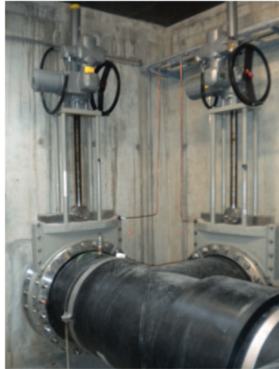
Die Kühlleitung ist mit Wey® Plattenschiebern MFA und MFE ausgerüstet.
